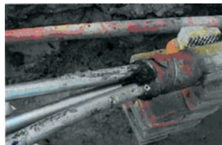
Fig. 2: Coroziunea ecranului exterior cu apariția de găuri în ecranul din Pb
