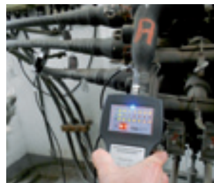
Măsurătoare PD Online PD pe un cablu MT cu senzorul HFCT.
