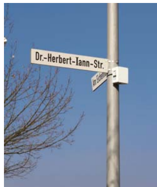
LOG GSM 3 pe un stâlp de iluminat
