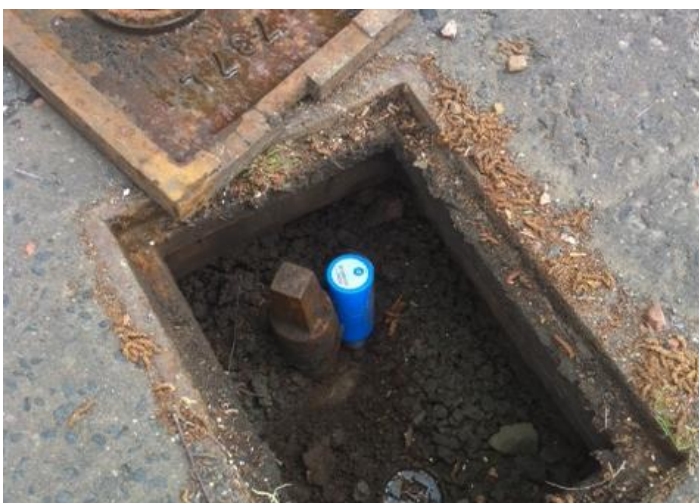
Sebalog N-3 instalat într-un cămin de vană subteran
