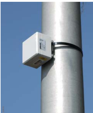
Repetor 3 pe un stâlp de iluminat
